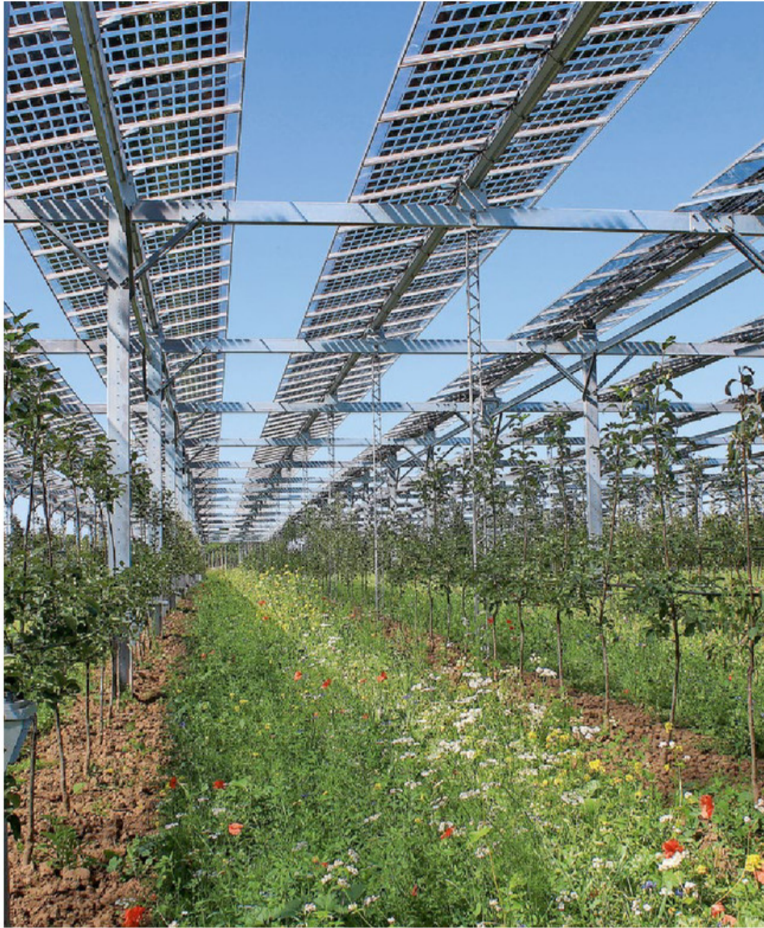
Agri-PV-Anlage auf dem Bio-Obsthof Nachtwey.
